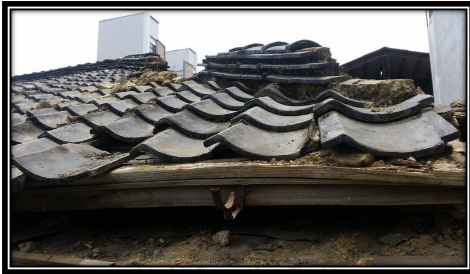
圖 4-7、屋頂損毀情形
