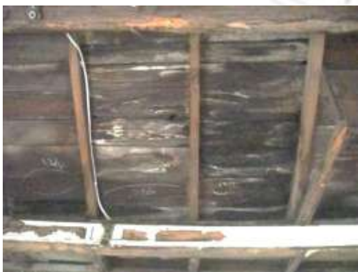
圖 42 天花板漏水的註記
