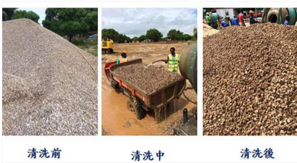
圖 4-8-17 清洗構築石頭-利用雨水清洗建築所需的石頭 資料來源：本研究拍攝
