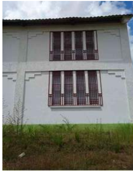
圖 3-3-37 倉庫防盜鐵窗 資料來源：本研究拍攝
