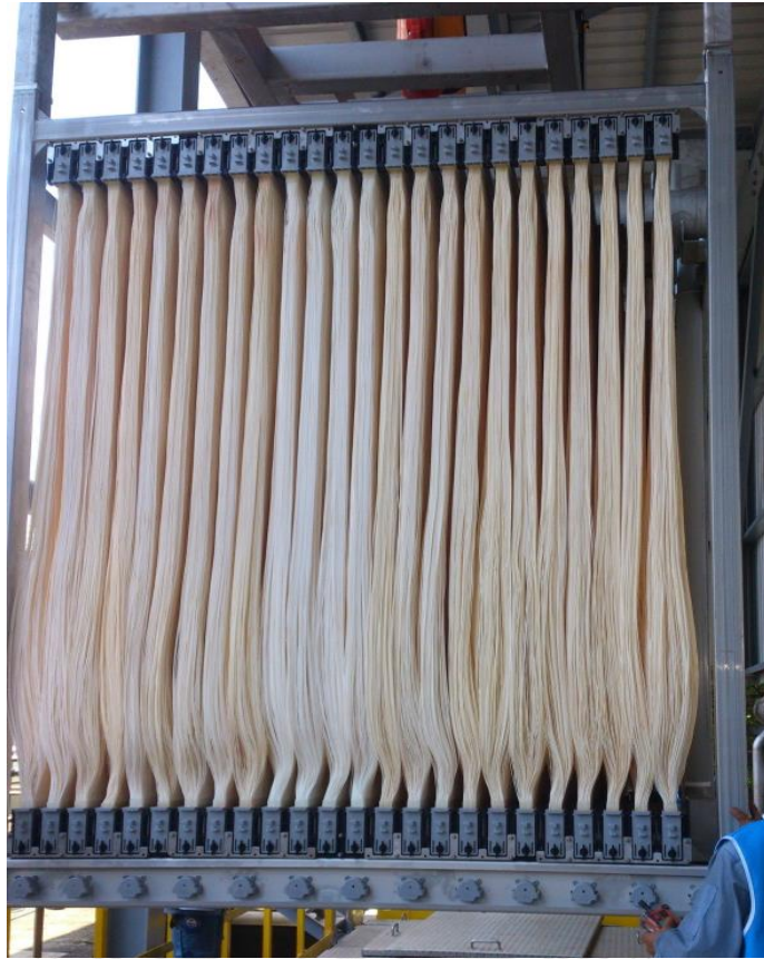
圖 3.6 新竹工業區污水處理廠 MBR 薄膜
