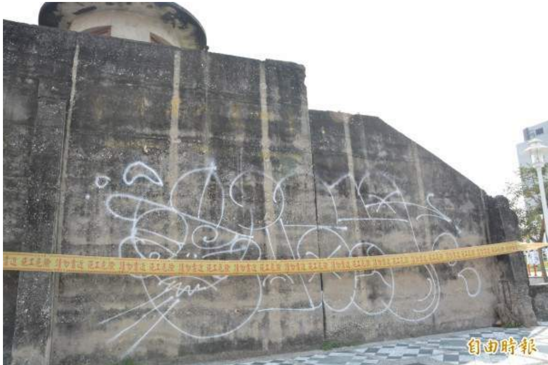
圖 2-11 花蓮舊監獄損壞情形
