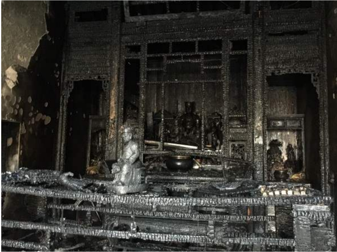
圖 2-10 鳳山寺損壞情形
