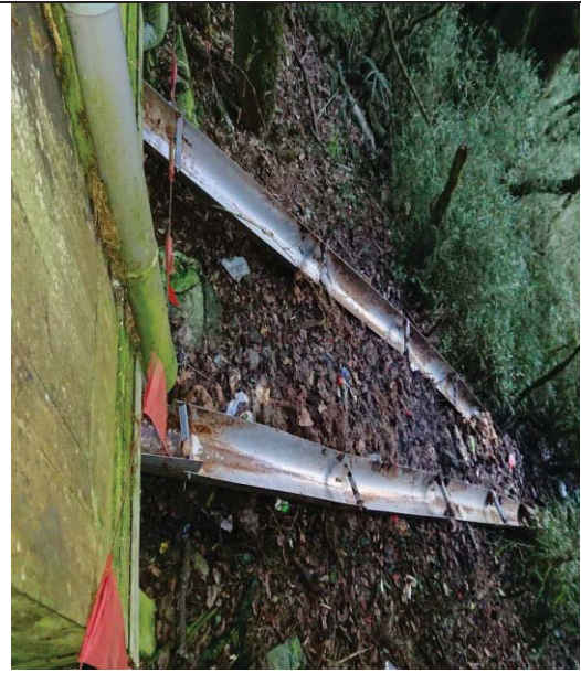
圖 4.32 雲稜山屋 拉管外排式廁所外的排遺管
