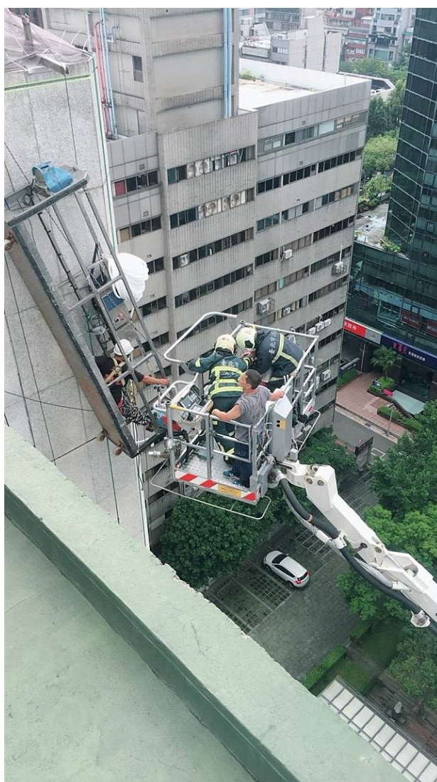
圖 2.1 消防人員於消防雲梯車上作業並無佩戴安全帶
