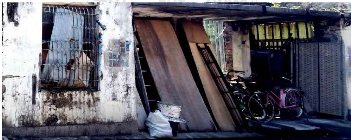
照片 5-51：公園路 736 巷 56 弄火災毀損建築物現況 資料來源：本研究自行拍攝
