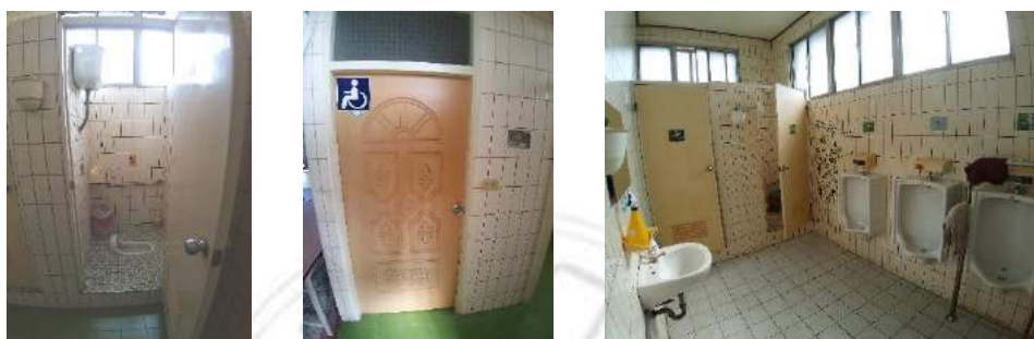
圖 65 上林里活動中心內廁所現況
