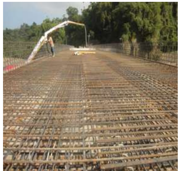
圖 3.2.2-24 預力梁橋的橋面鋼筋鋪設與紐澤西護欄鋼筋結構 (本研究拍攝 2011.07)
