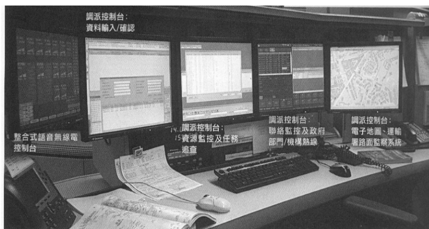
圖4-4 香港消防處控制中心調派控制台
