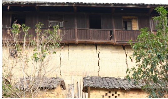
圖 4-2-3-12、夯土牆結構縱向劈裂現象
