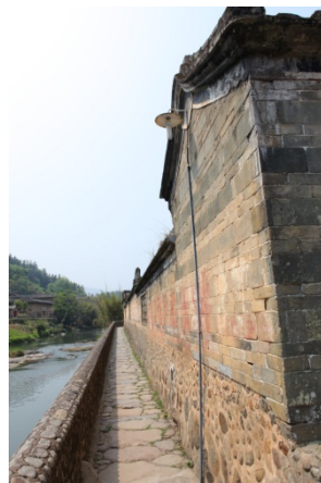
圖 4-2-3-16、未與古蹟隔離的照明設備
