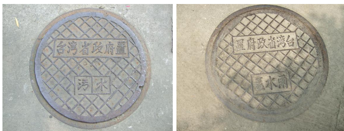
圖【3-9】中興新村的排水設施
